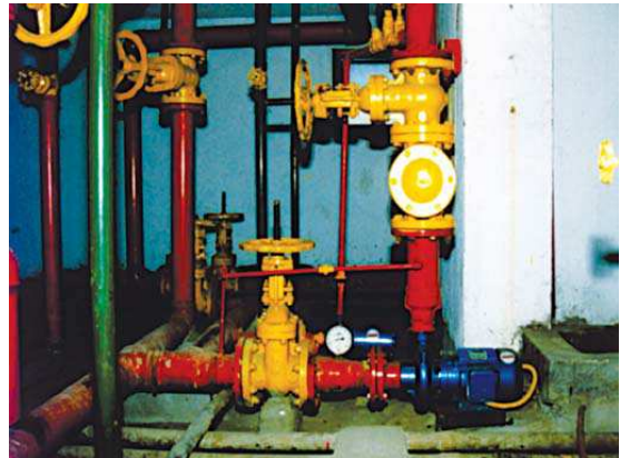
Figura 20: Bomba de incêndio e acessórios hidráulicos
